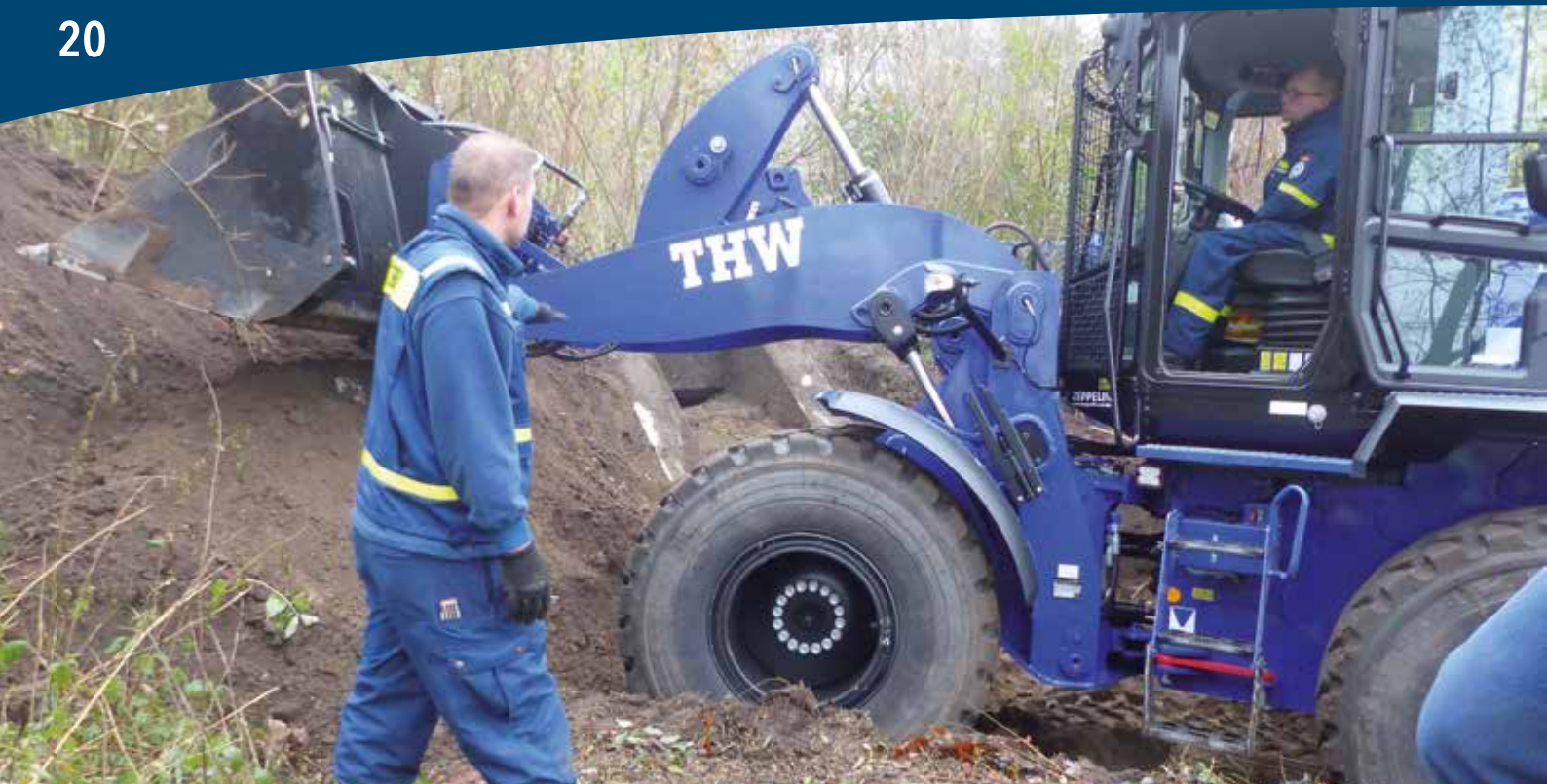
Die THW-Bergungsgruppe mit Radlader im Einsatz am Bunker in Bergeshövede. (Foto Klaus Offenberg)
